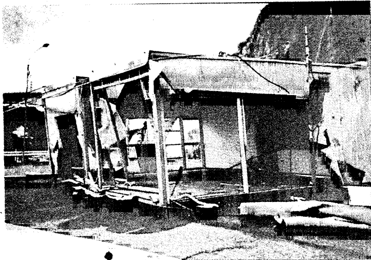
図5. 台風で全壊した事務所
