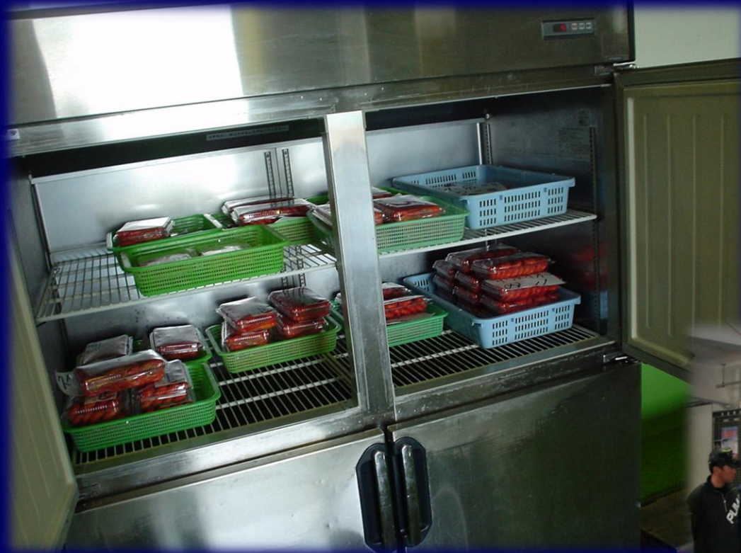
設備された冷蔵庫
