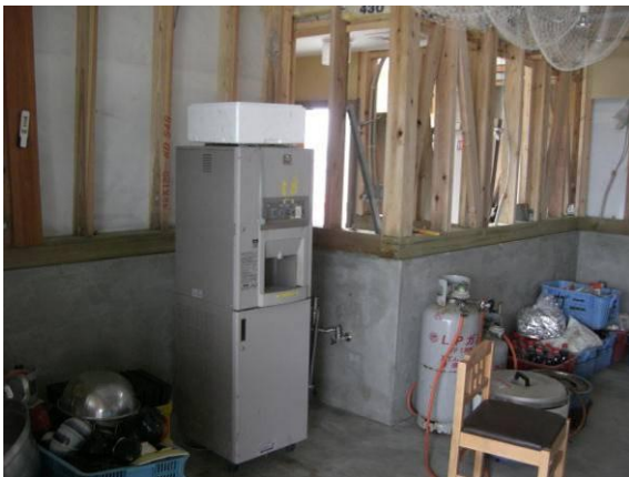
写真 7 津波の被害で破損した店内
